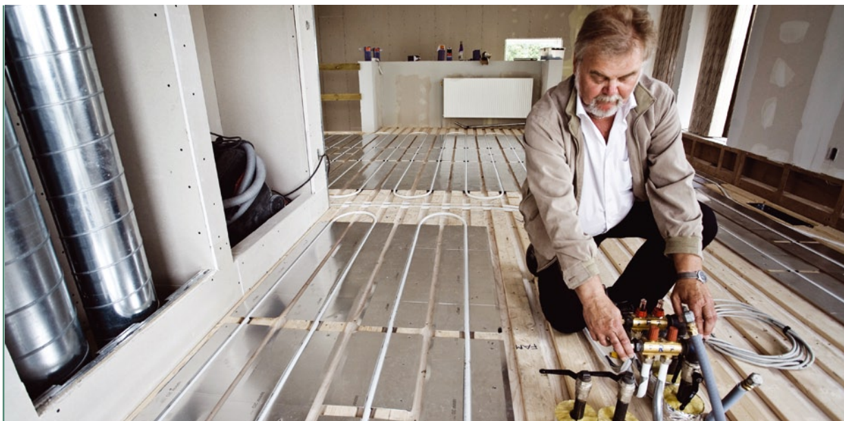
Energy FlexFamily er en teknisk udviklingsfacilitet og en del af Teknologisk Instituts Energy FlexHouse. I Energy FlexFamily kan virksomheder afprøve varierende energiinstallationer og styringssystemer i en sammenhæng.
