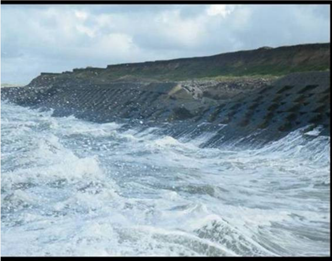
Vi ser her at skråningsbeskyttelsen er styrtet sammen nord for hofde Q i 2008
