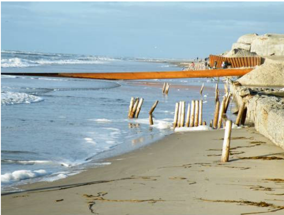
Her ser vi røret som ligger 1 km ud i havet og ind på stranden.
