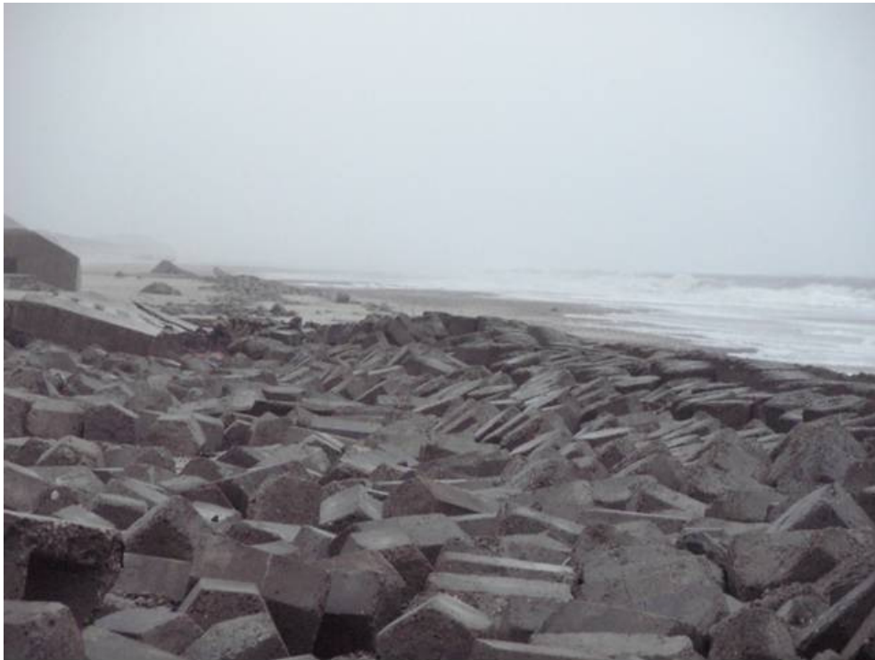
Sammenstyrtet skåningsbeskyttelse ved Krogen
