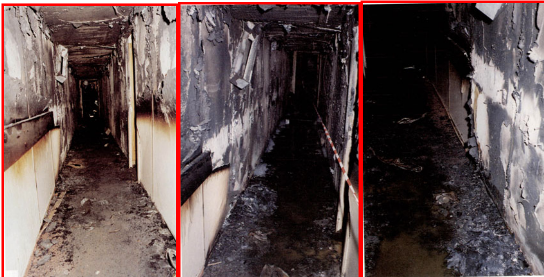
Figur 9. 3 st. bilder visande skador i korridor på däck 3 styrbord sida, akterut från trappa D s (2 SB). Dörröppningen som syns till höger i den vänstra bilden leder in till hytt 219. I denna korridor anlades brand nr. 2 (Huvudbranden).
