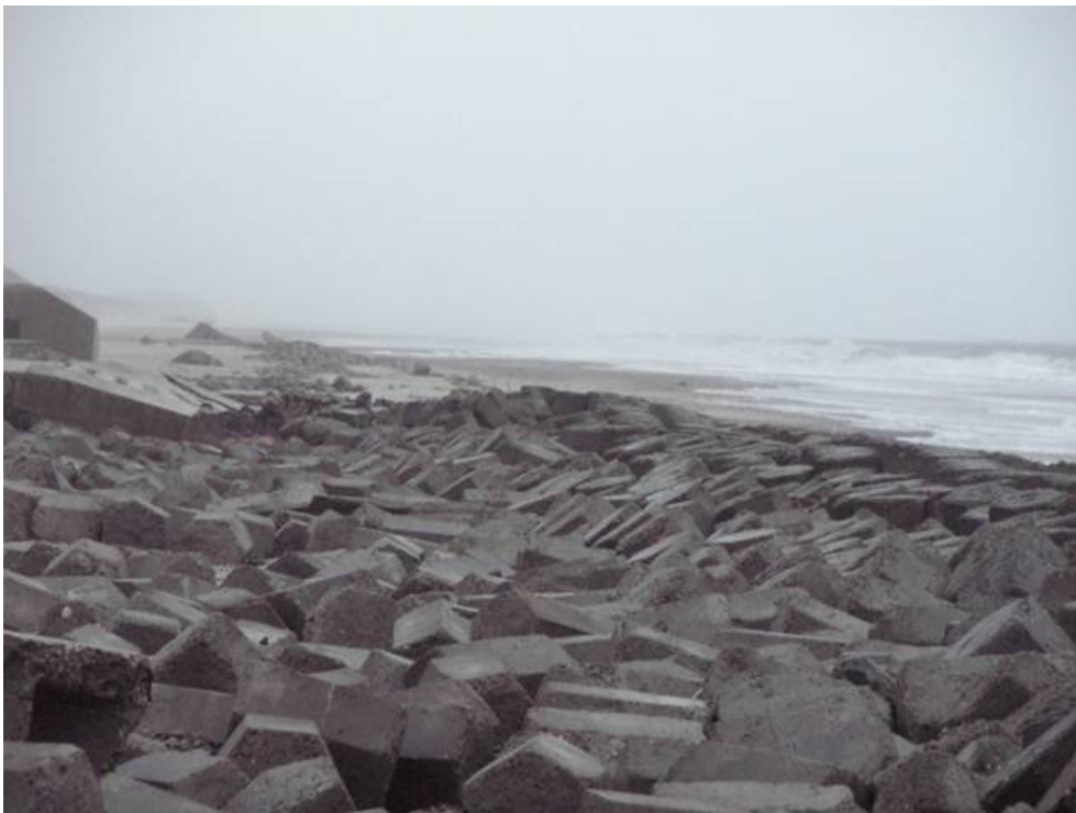
Sammenstyrtet skåningsbeskyttelse ved Krogen
