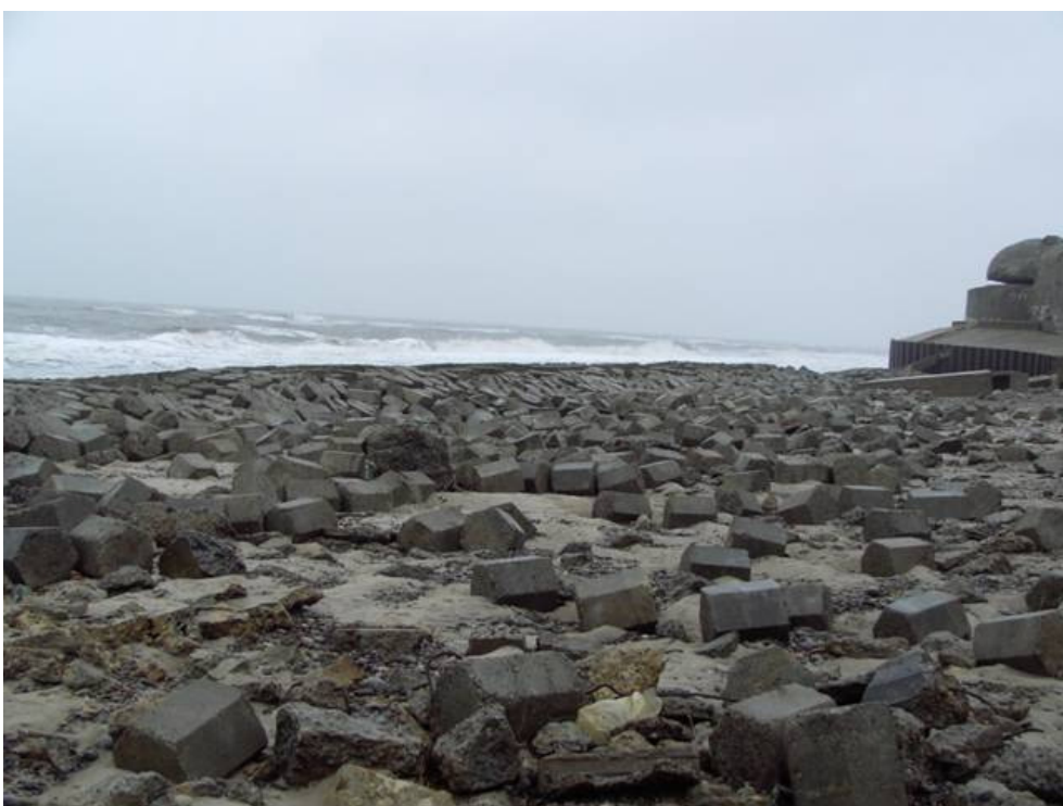
Sammenstyrtet revetment ved Krogen. Det har ikke været muligt at stoppe erosionen med strandfodring
