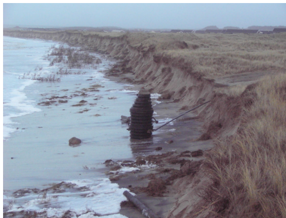
Høfderne ved Skallerup Klit har medført stor læsideerosion nord for høfderne.
