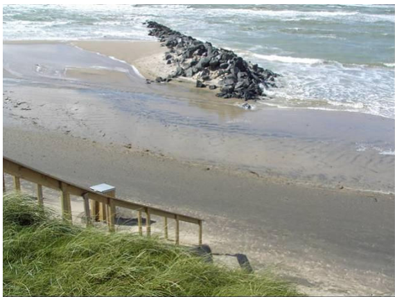
Høfderne ved Skallerup Klit Ferie Center lå 40 m ude i havet efter vinterens storme 2006/07
