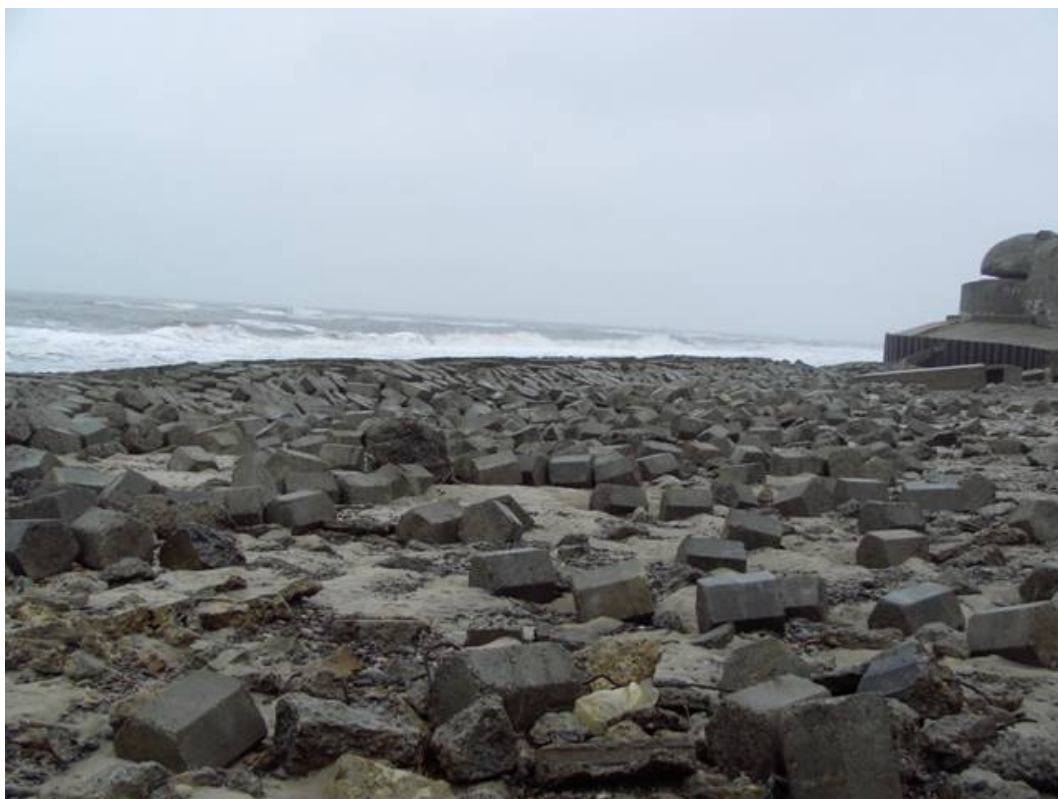
Sammenstyrtet revetment ved Krogen. Det har ikke været muligt at stoppe erosionen med strandfodring
