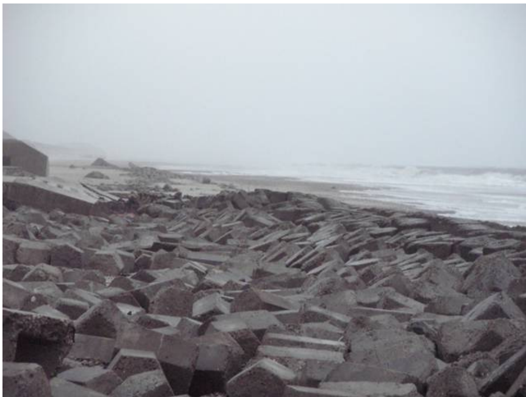
Sammenstyrtet revetment ved Krogen
