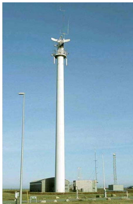
Radar tårn, VTS-systemet, Storebælt
