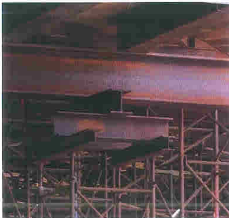
Figur 19 Udført overgangskonstruktion beregnet til tårn med 1 donkraft. Donkraften er ikke monteret, idet højden i stedet er justeret på tårnets spindler
