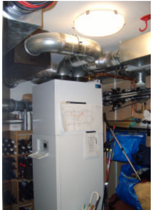
Et moderne ventilationsanlæg sparer på energi og penge
