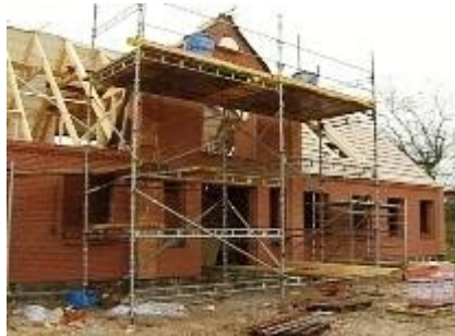
Også små byggepladser overtræder arbejdsmiljøloven
